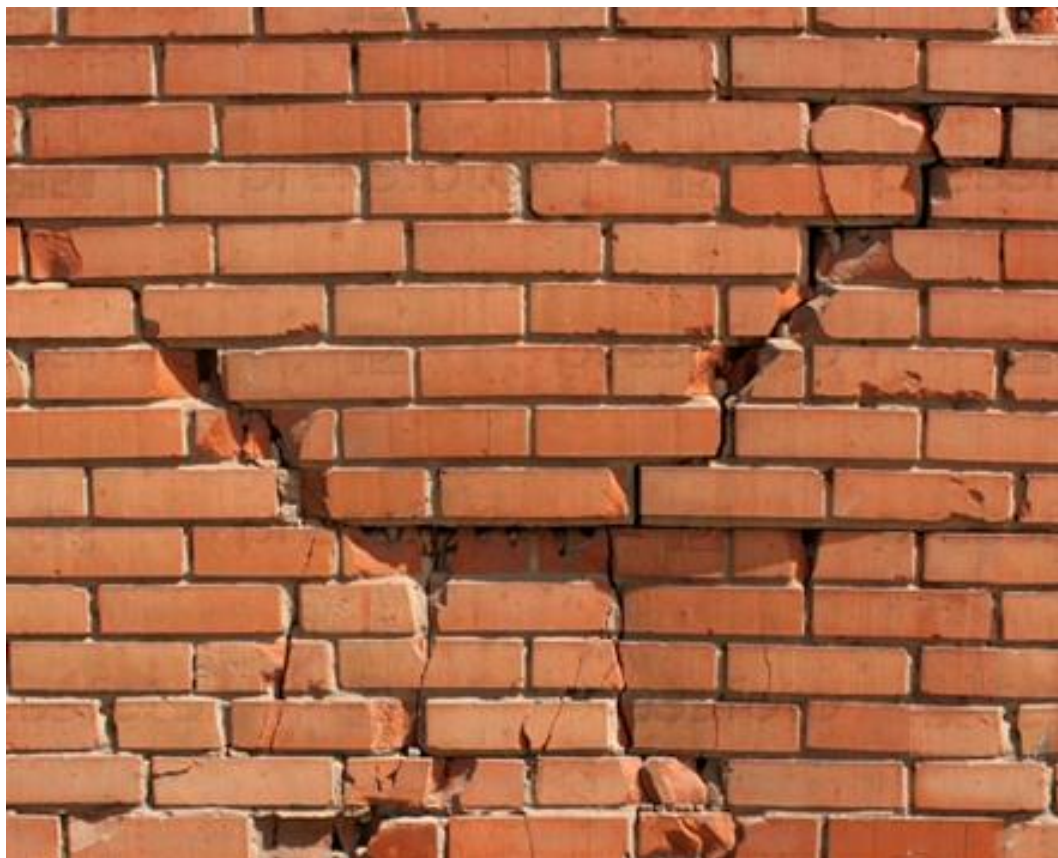
Рисунок 13. Множественные силовые трещины кирпичной кладки
