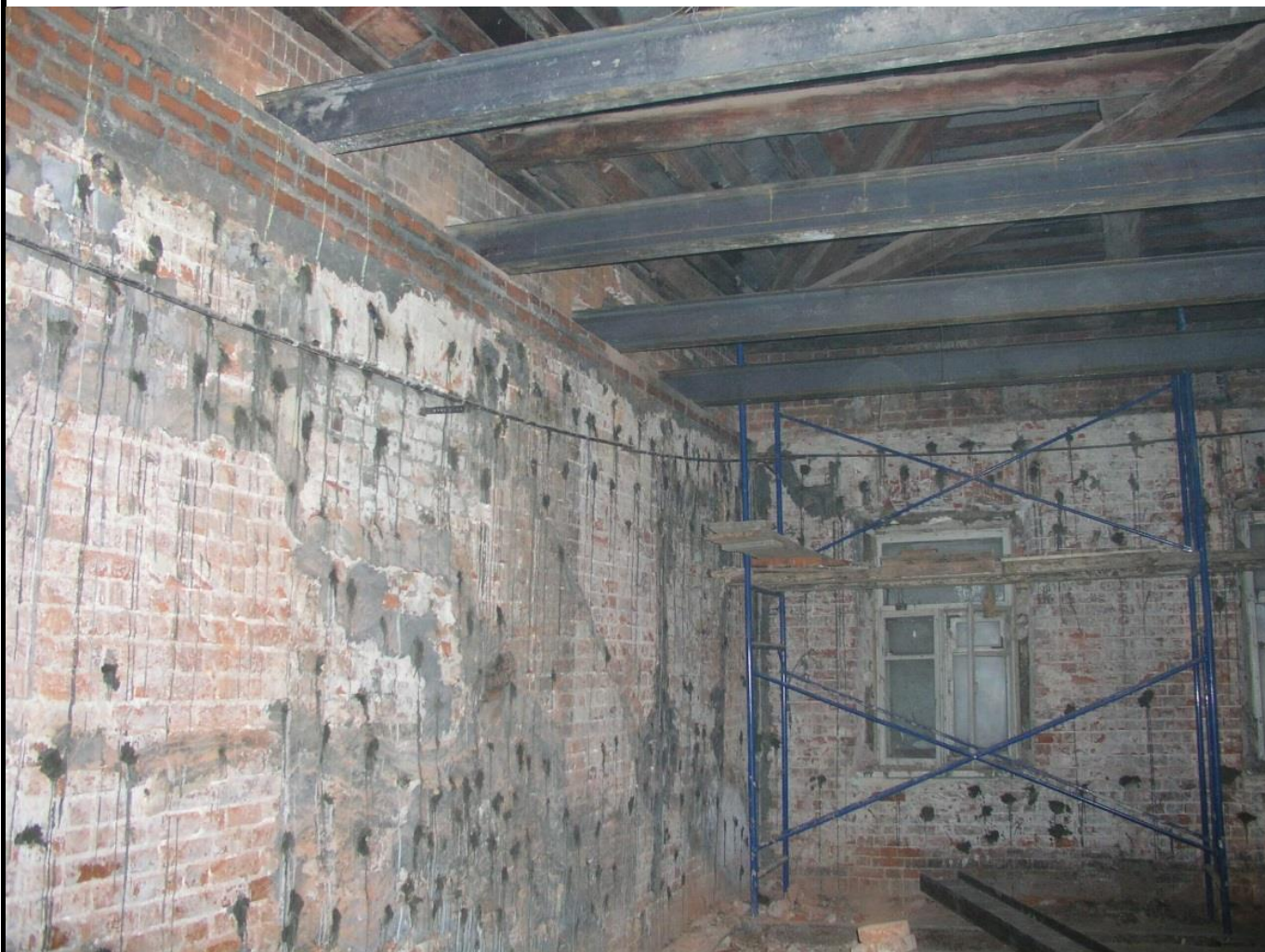
Рисунок 16. Инъекция раствора в кладку с множественными трещинами с целью повышения ее монолитности и расчетного сопротивления сжатию
